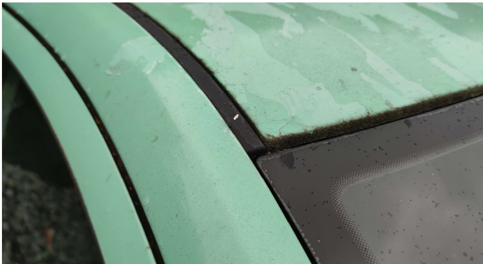
Obr.9 Prasklina a loupání laku na platu střechy
