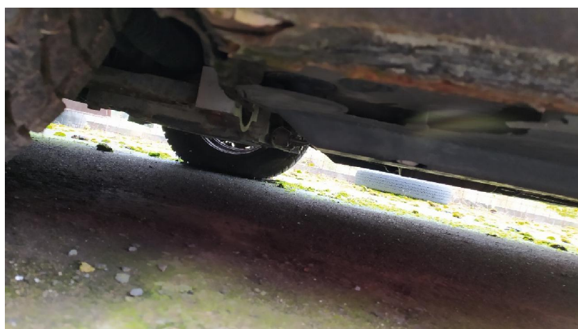
Obr.7a,b Koroze prahů
